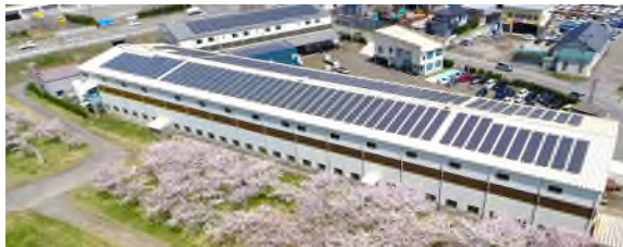
(太陽光発電事業) 本社工場屋根の太陽光パネル
